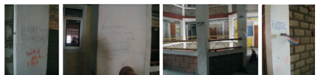
Gambar 15: Kerusakan fisik permanen di rusunawa Cigugur (Sumber: survai 2012)
