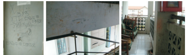
Gambar 17: Kerusakan fisik permanen di rusunawa Cingised. (Sumber: survai 2012)
