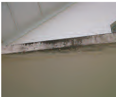
Gambar 21. Penjamuran penampang dak beton.
