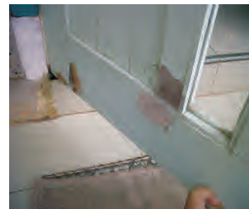
Gambar 17. Kerusakan pintu kapel yang lain.
