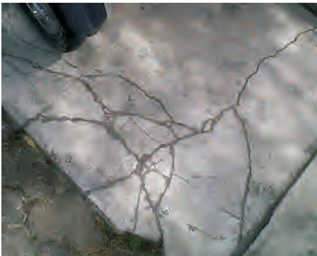
Gambar 20. Kerusakan pada jalur sirkulasi samping.
