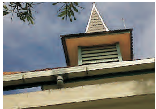
Gambar 24. Pelapukan pada tower minaret.
