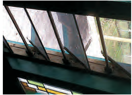
Gambar 22. Pengkaratan pada jendela kaca nako.
