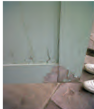
Gambar 16. Kerusakan pintu kapel.
