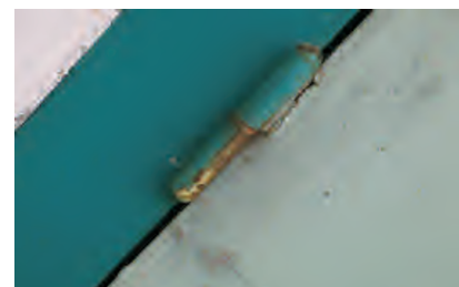
Gambar 18. Kerusakan pada engsel pintu kapel.
