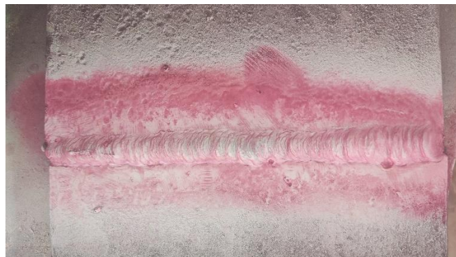
Gambar 6. Hasil pemeriksaan uji Non-Destructive Test (NDT) menggunakan metode Liquid Penetrant yang menunjukkan cacat pada sambungan las, ditandai oleh anak panah.
