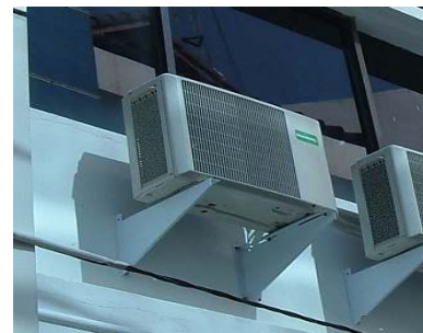
Gambar 2. Jenis Kondensor Terpasang
