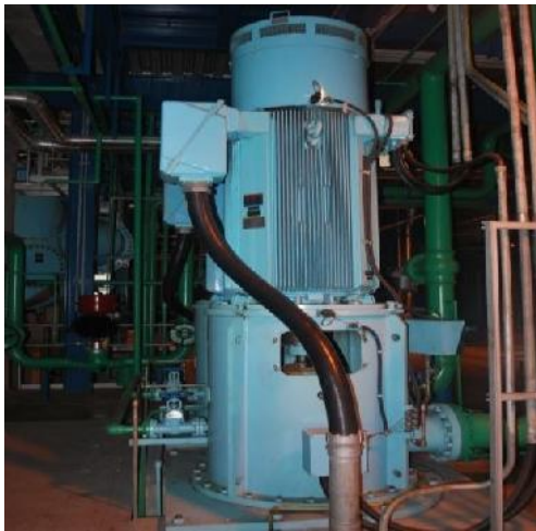
Gambar 2.3 Condensate Pump 3A PLTU Tarahan
